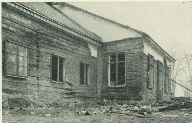
Fig. 3. På sjösidan hade timret på flera ställen angripits av röta, något som framgår av denna bild. Man kan här också se, hur salsutbygget och dess fönster höjts; den ursprungliga taklinjen framgår av lappningarna ovanför * det stora fönstret på salens kortvägg.
