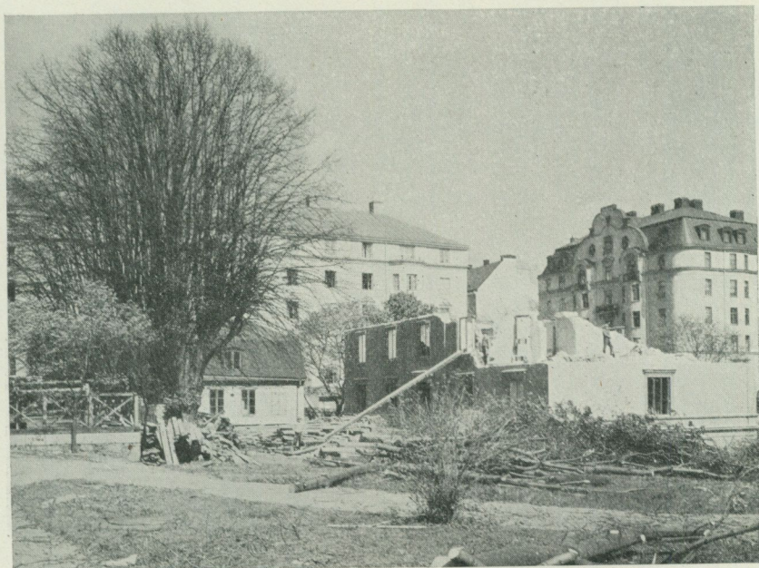
Fig. 5. Tomten vid Surbrunnsgatan under pågående rivning. Till vänster den övre terrassen och lindraden, till höger Pavres Honteux' hus från 1871, under rivning.
